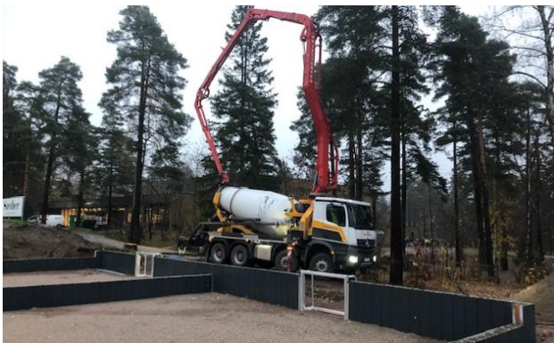
8. november kl 0730 kom betongbilen for å fylle betong i bunnen av alle veggmodulene.
